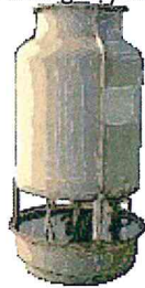
Bồn nước không sử dụng hoặc không đậy nắp
